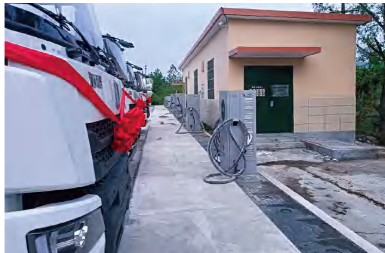
杭州重卡超充站
